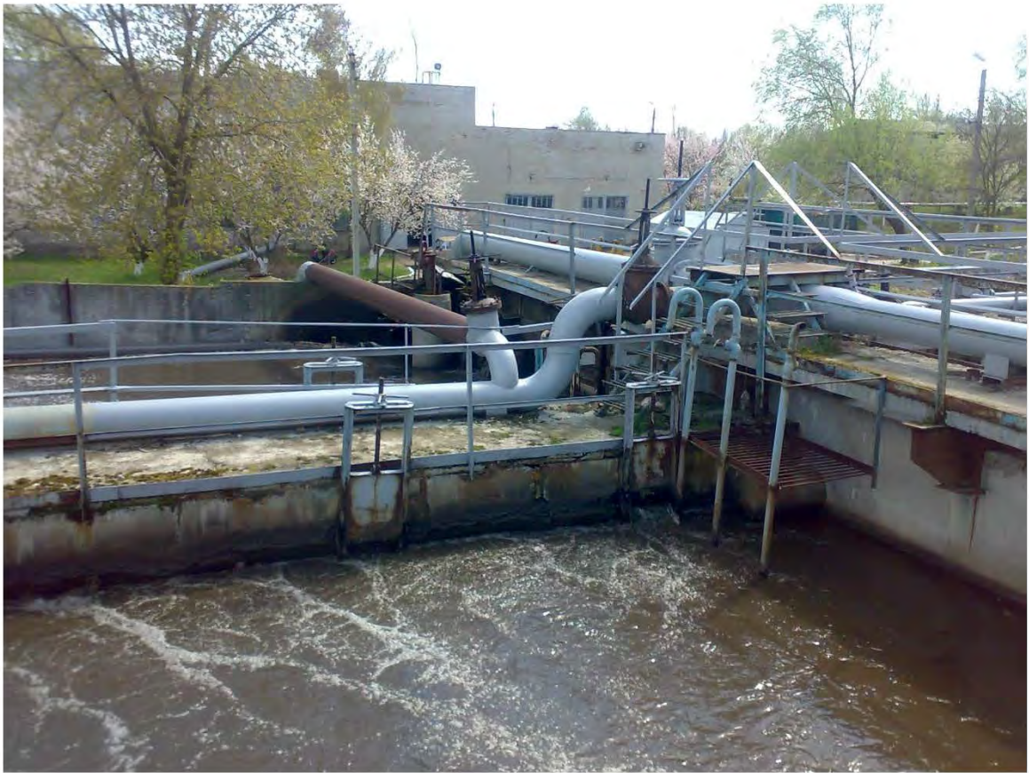
Рис. 8. Очисні споруди м. Боярка
