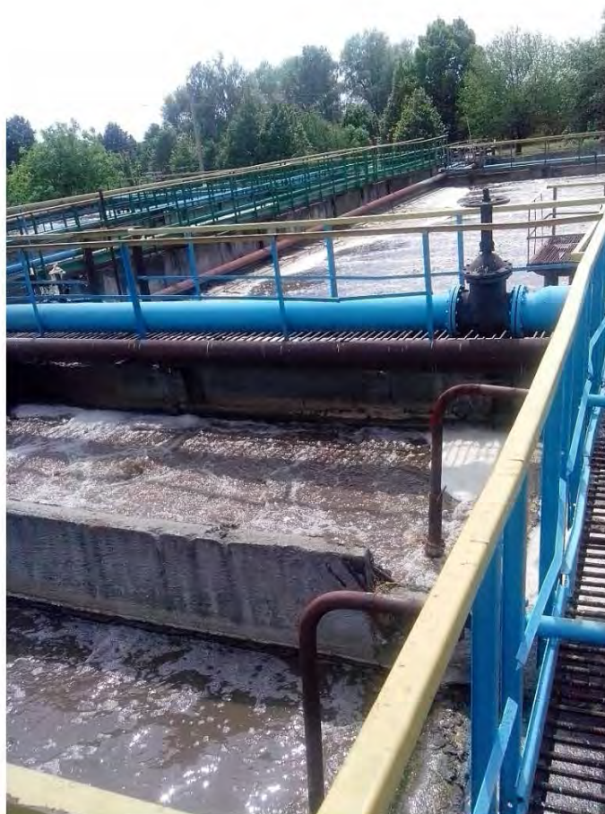
Рис. 2. Очисні споруди м. Кременець
