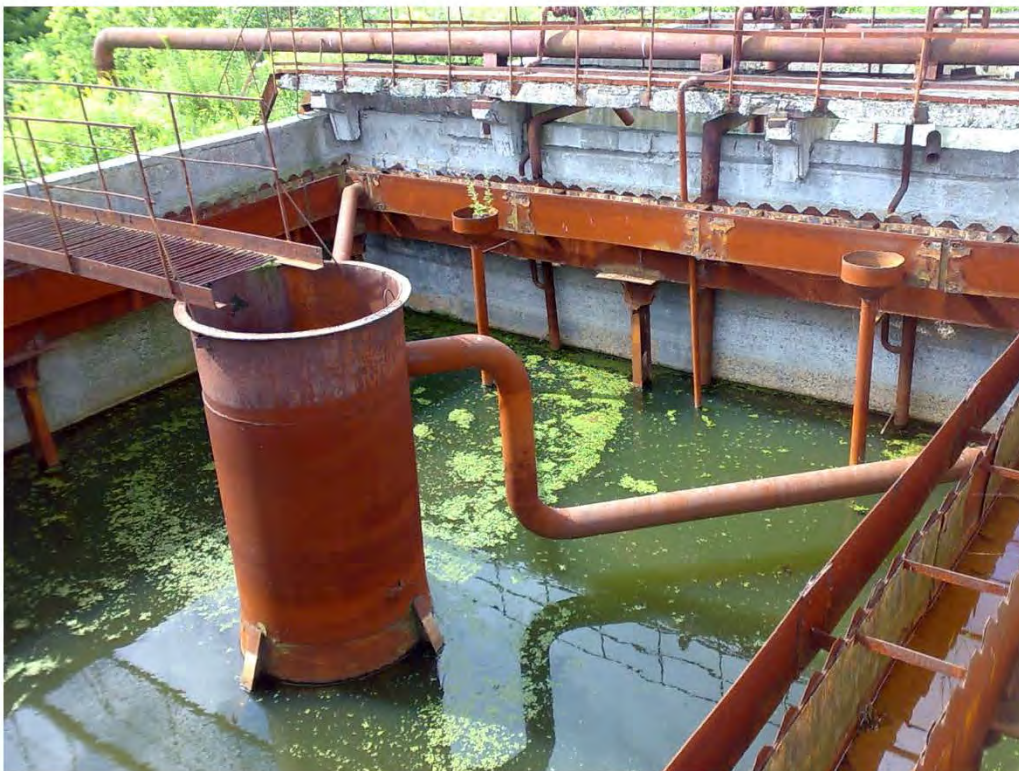
Рис. 6. Очисні споруди м. Кременець
