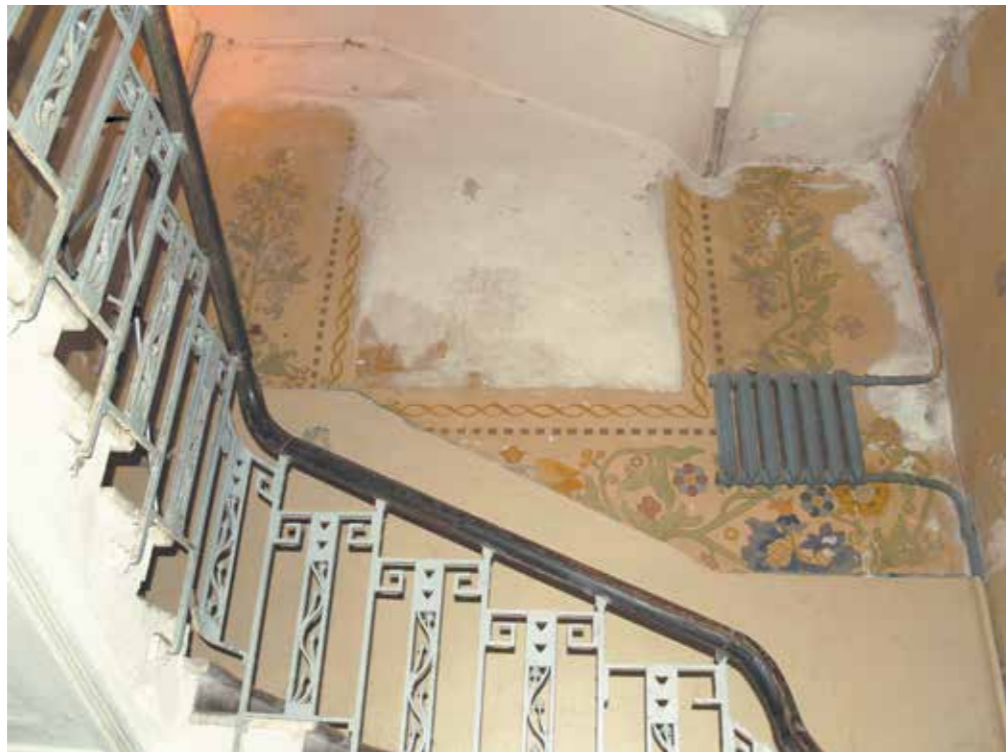
1914–1915 рр., Хар- ків. Розписи північної стіни парадних сходів будинку І. Бойка (в центрі знаходилося живописне панно С. Васильківського). Худ. М. Самокиш. Світлина В. Шуліки. 2021
