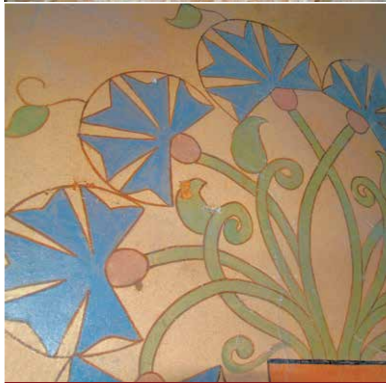
Руйнування фарбового шару розписів парадних сходів в будинку І. Бойка. Світлина В. Шуліки. 2021
